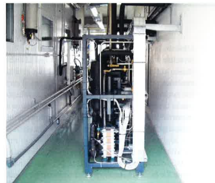
Impianto di prova LU-VE
